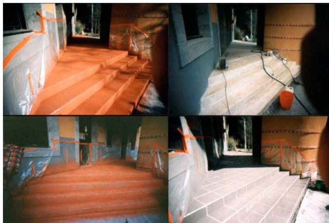
PROTECTION DU CHANTIER. POSE DES ADHESIFS POUR FAIRE LES CARREAUX ET PROJECTION EN TEINTE ROUGE DE LA COUCHE FINALE AVANT LE RETRAIT DES ADHESIFS.
